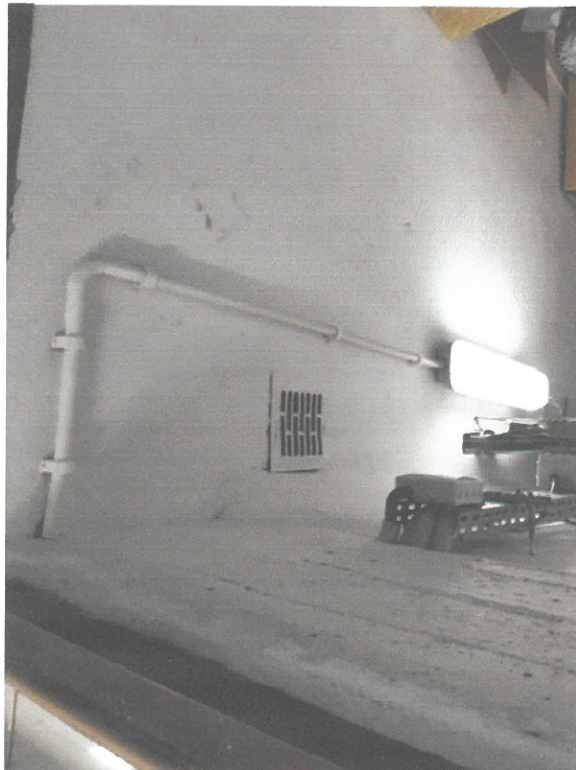
Pomieszczenie pod rozdzielnicą nn
